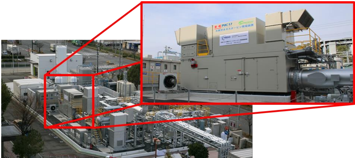
Abbildung 2: weltweit erste Installation einer Wasserstoff-Gasturbine in Kobe, Japan
